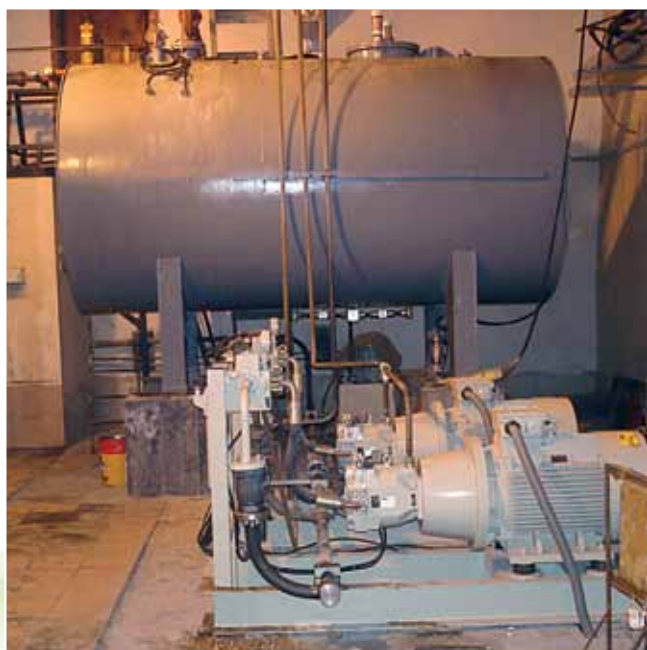
Маслонапорная установка (МНУ)
