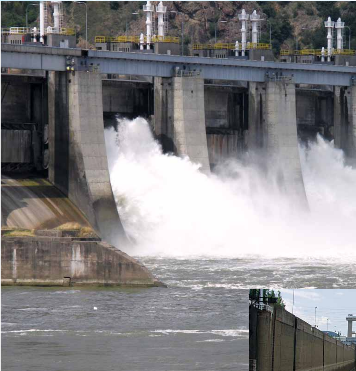
Водосливы плотины – гидравлическое оборудование для сдвоенных крючкообразных затворов
