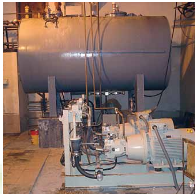
Маслонапорная установка (МНУ)
