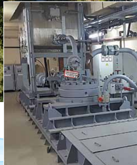
Гидравлический агрегат АРЗ со шкафами энергетики и автоматики
